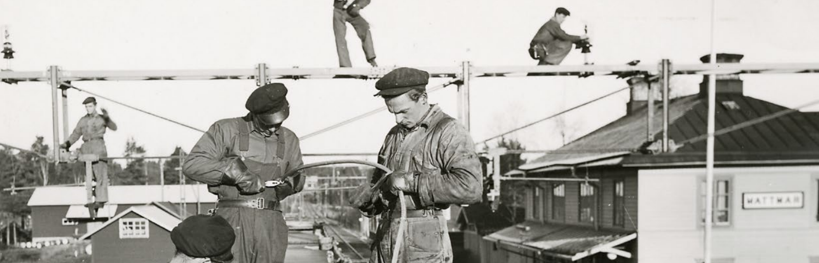
Arbete med kontaktledningar vid Mattmar under elektrifieringen av sträckan Östersund–Storlien, november 1944. Foto: Järnvägmuseet, JvmKDAF02359
